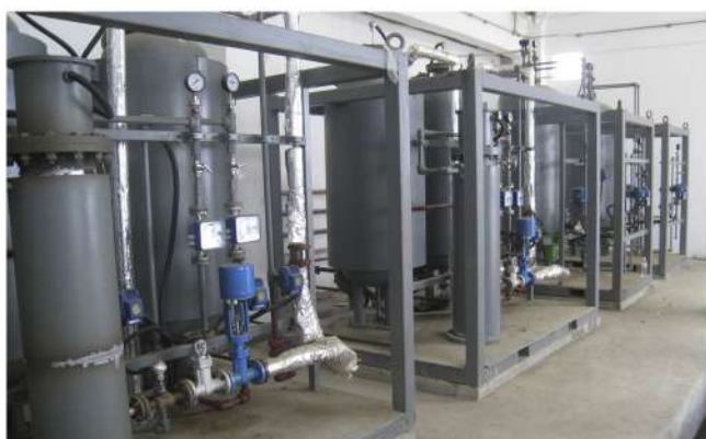
Generadores de gas cloro y argón
