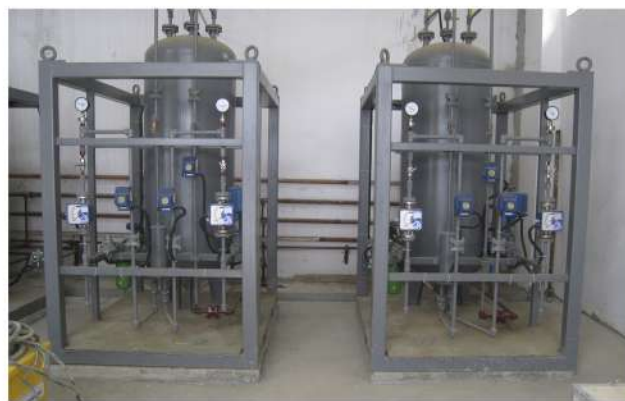
Generadores de gas cloro y argón
